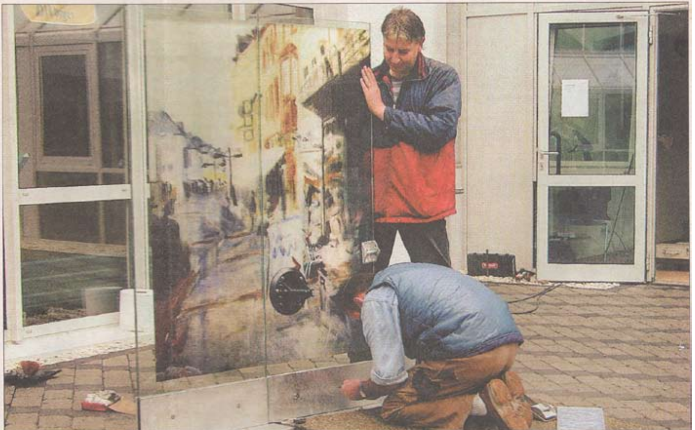
„Schüttgut“ hieß die Aquarellvorlage für die Bildwand im Innenhof, die hier gerade montiert wird.
